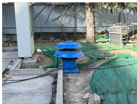
污水处理站废气排气口
