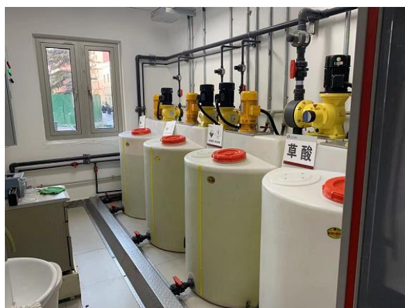
污水处理站加药间
